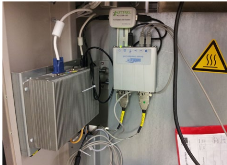
Fig. 1: APS - Box in situ.
